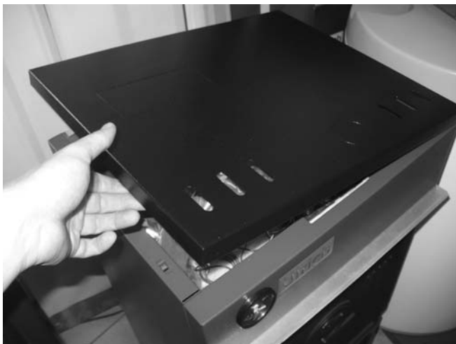
1. Zdjąć górną obudowę kotła.
