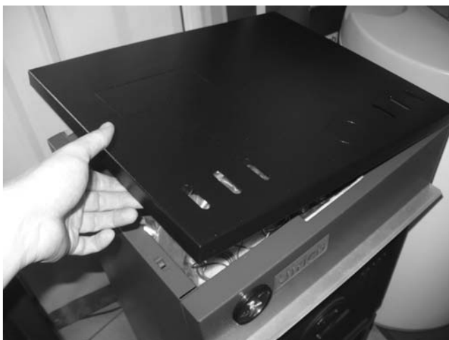
1. Zdjąć górną obudowę kotła.
